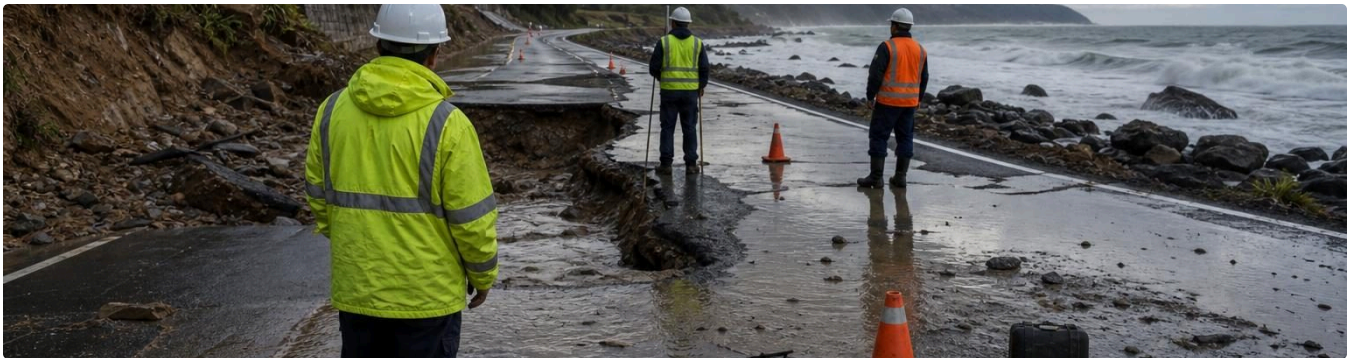
Trabajadores inspeccionan daños por inundación en una carretera costera bajo cielos nublados.
